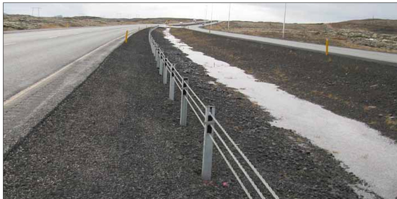
Víravegríð við Reykjanesbraut. Lokið er uppsetningu á 8,6 km. Væntanlega verður framhald á verkinu boðið út í ár.
